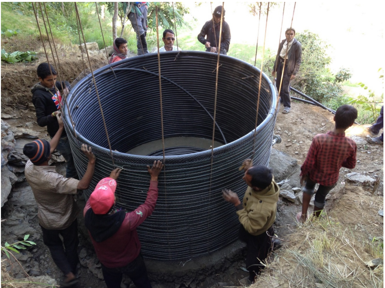
Ein neues Wasserreservoir entsteht unter aktiver Mitwirkung der lokalen Bevölkerung. Unten links: Anlegen von Gräben für Wasserleitungen. Unten rechts: Das fertiggestellte Wasserreservoir.
