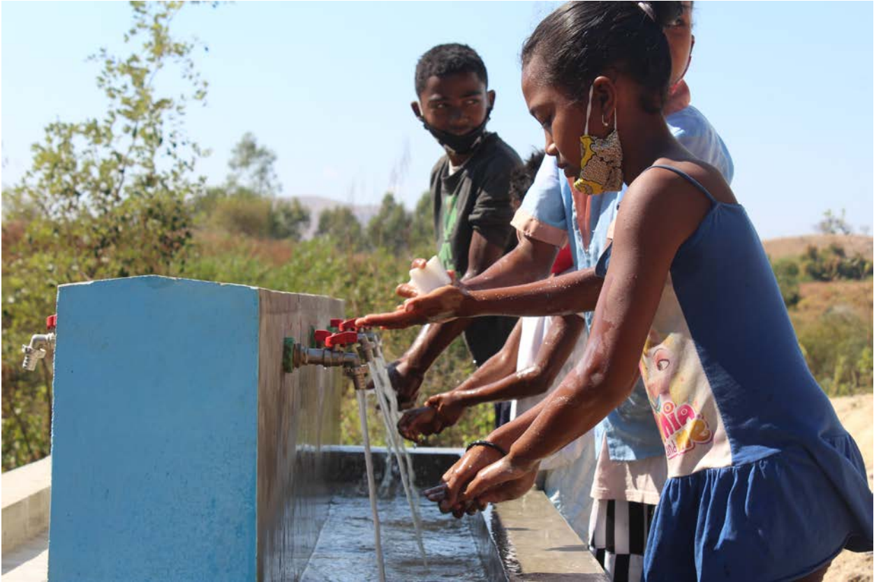
Handwaschstation mit 8 Hahnen und Latrinen an der Schule Andranomainty
