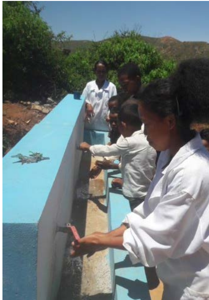
Handwaschbecken mit 4 Wasserhähnen in der Schule Manazary
