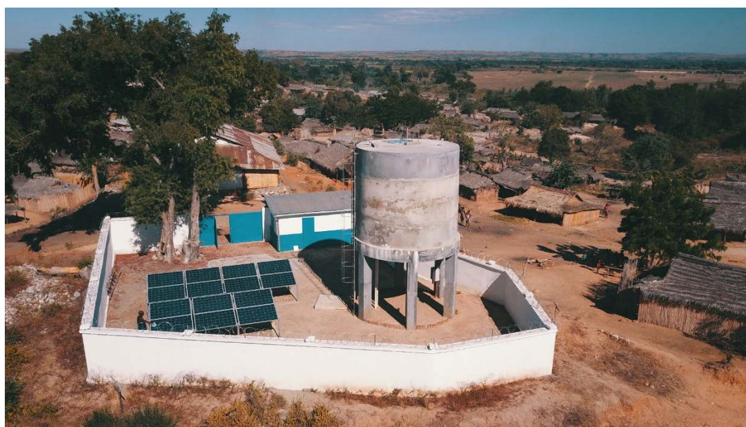
Die Wasserversorgung mit Wasserturm und Solarpumpe von Manambina. Diese versorgt verschiedene Wasserzapfstellen und -kioske in der Gemeinde.
